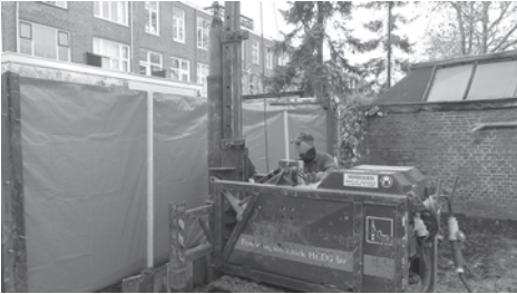
Heistelling voor de stalen buispalen is bezig de palen tot 1,5m diepte te heien
